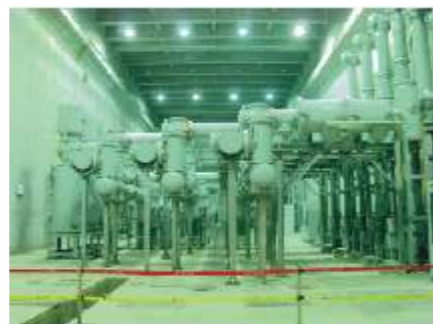
500KV GIS设备
